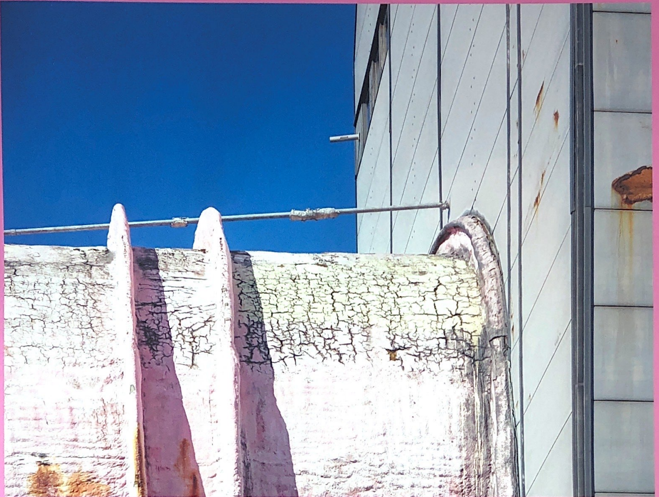
Der verwitterte und rissig gewordene PU-Schaum wurde zusätzlich durch Spechte und sprießende Pflanzen beschädigt. © adb Ewertien und Obermann
